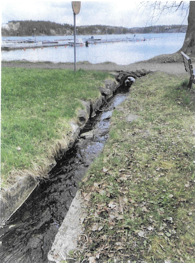
Figur 7. Befintlig stenkanal med trumma nedströms som har sitt utlopp i Baggensfjärden. Stenkanalen ska breddas norrut, vilket är till vänster i bilden.
